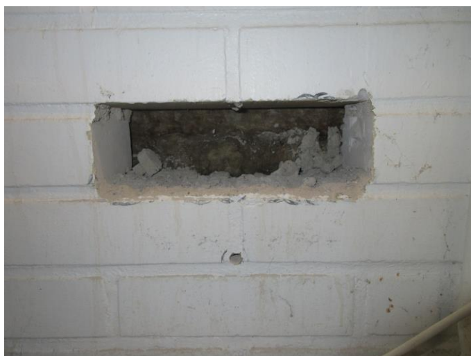
Kuva 2. Eristevilla seinän sisällä oli tummunutta.
