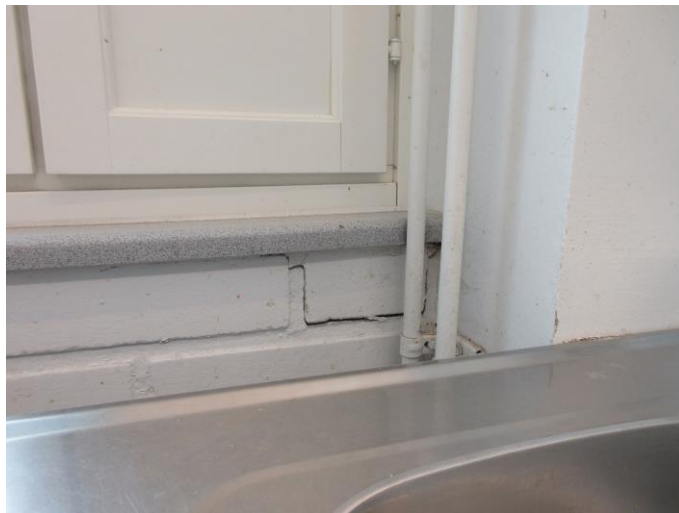
Kuva 1. Tilan 114a seinärakenteessa havaittiin halkeamia.
